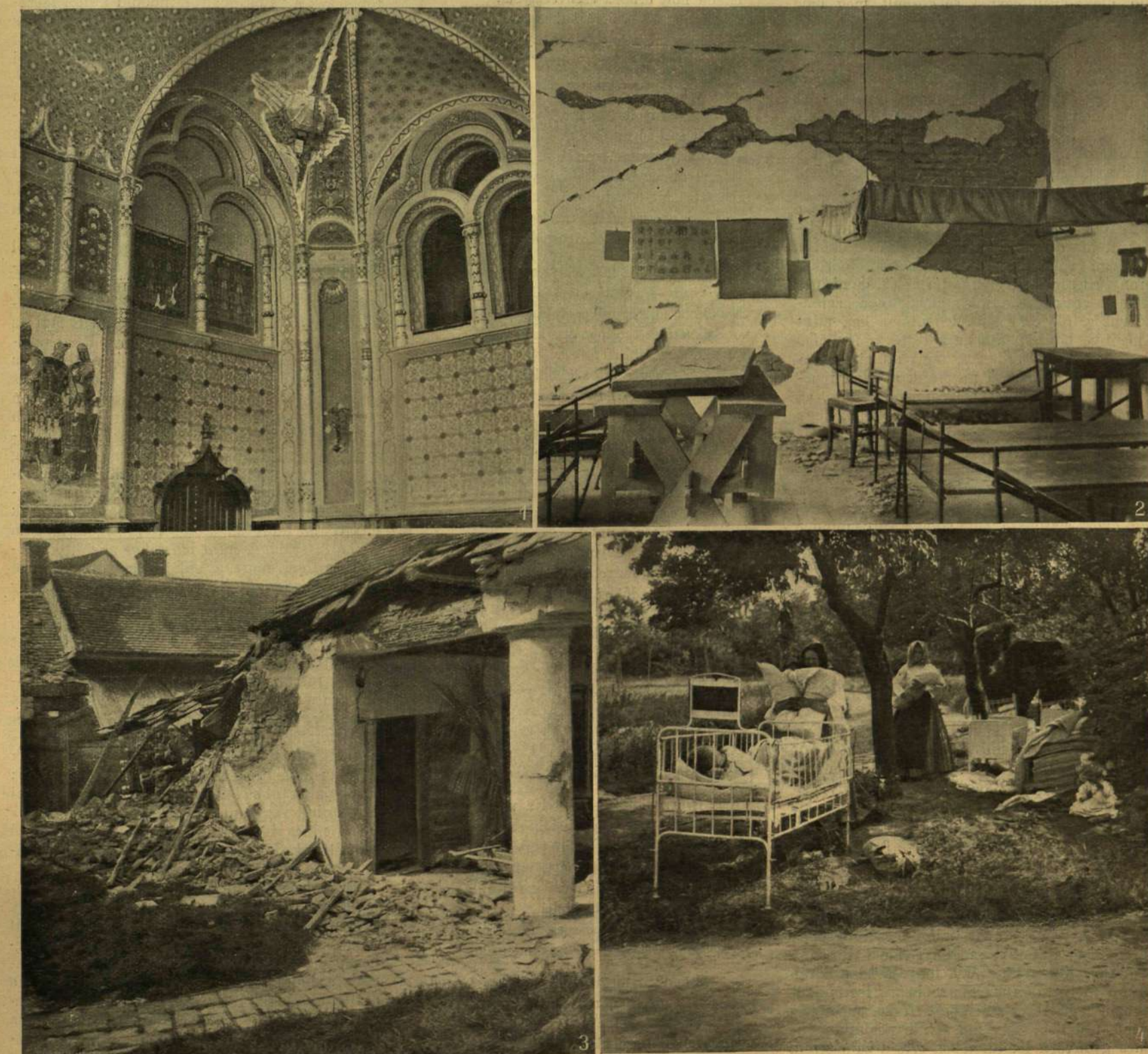
1. A város-háza közgyűlési termének beszakadt mennyezete. — 2. A Mollináry-bakák laktanyájának egyik legénységi szobája. — 3. Összedőtt ház a nagykörösi-utczában. — 4. Az állami gyermekmenhely kilakoltatott házépje.
