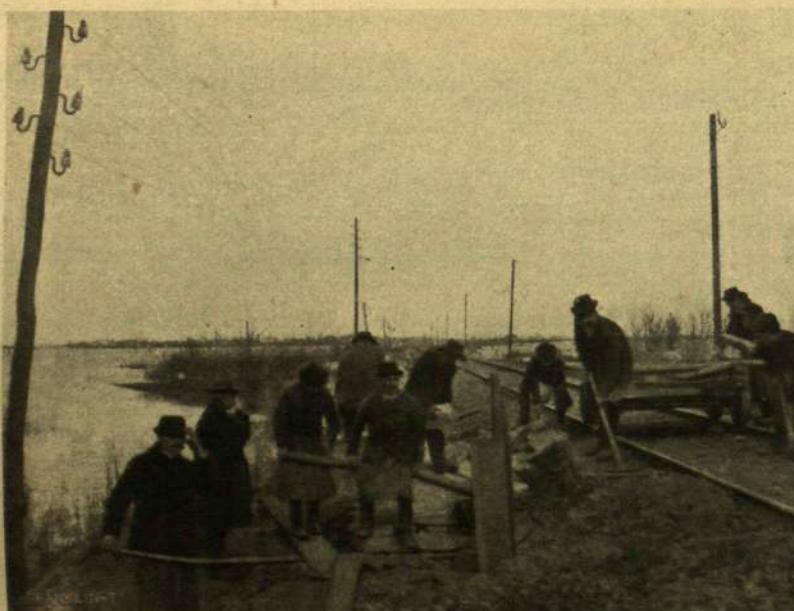
JAVÍTJÁK A MEGCÚSZOTT VASÚTI TÖLTÉST.
