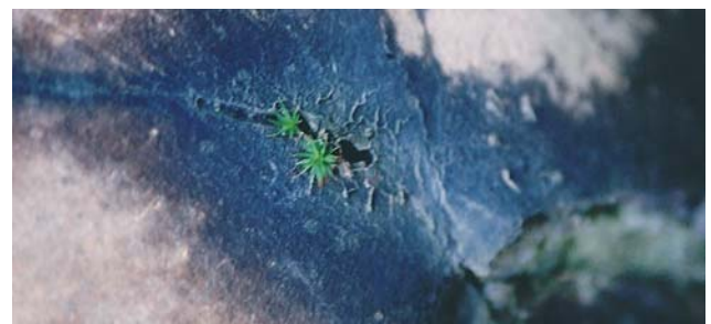
5. kép. A repedésekbe telepedett apró növények gyökereikkel feszegetik a rést
