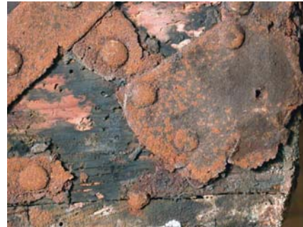
26. kép. Nagymér- tékben károsodott, helyenként átkorro- dálódott vasleme- zek.
