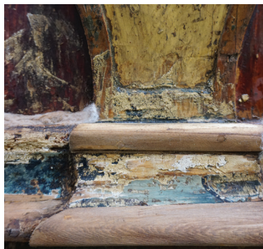
12. kép. Fakiegszítések a jobb oldali pilaszter talapzatának alsó részén.
