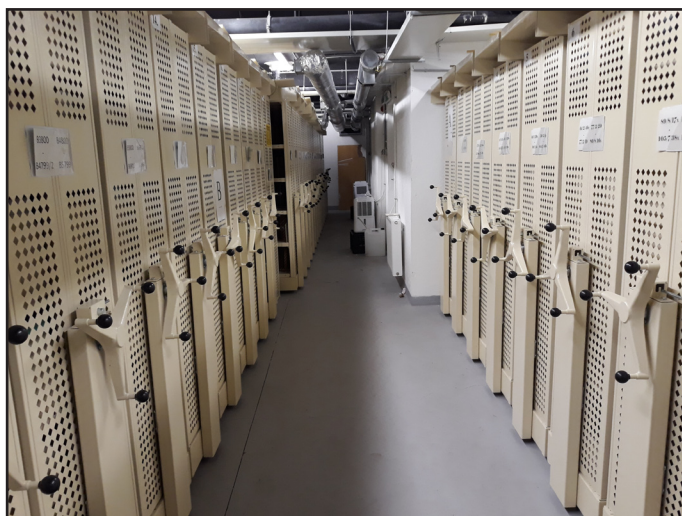
Tömörraktár, a gördíthető polcrendszer között mobil páramentesítőekkel
