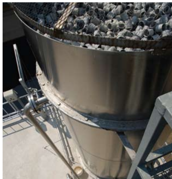
A hulladéklerakóban képződő folyadék ammóniatartalmának kivonására szolgáló berendezés.
