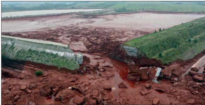
Il punto della rottura della diga
