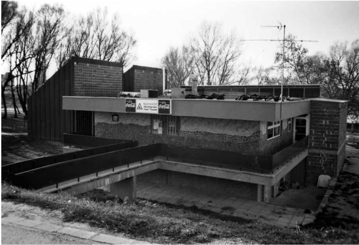
6. A győri szabadstrandi öltözőépület állapota a kétezres évek elején, 2000 körül Fotó: Pilt Rudolf, Pilt Rudolf hagyatéka (magántulajdon)
