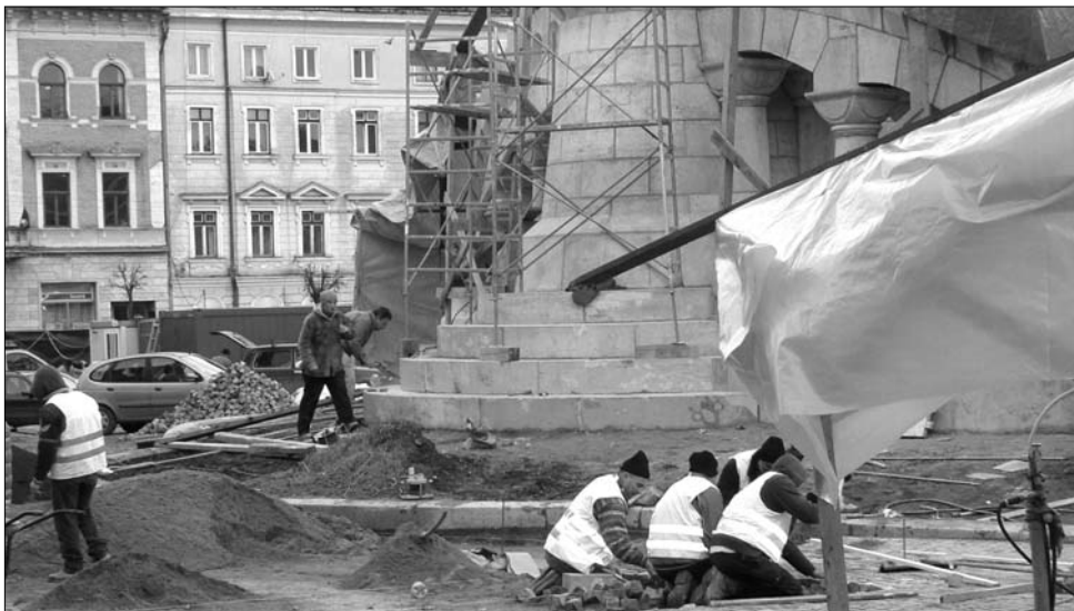
A korábbi építőtelep területét kőburkolattal rakják ki, a tér újra Főtér lesz
