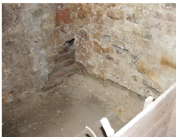
54. ábra – A leszakadt falsarok a Kard utca 4. utcai oldali pincéjének északnyugati sarkában (fotó: szerző, 2016. 04. 25.) Fig. 54 – The collapsed wall corner in the northwest corner of the cellar at 4 Kard Street (photo: author, 25 April 2016)
