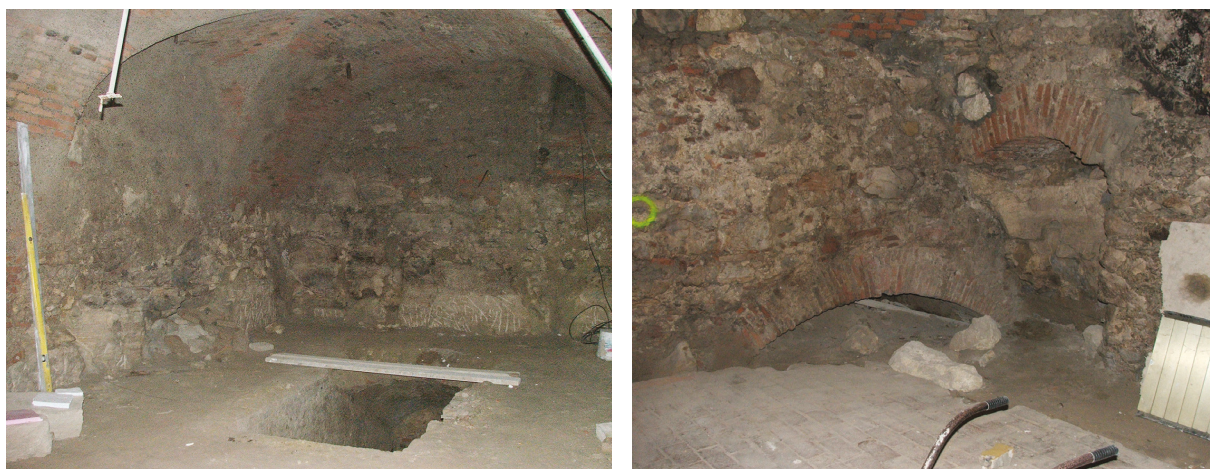
50. ábra – Az Országház utca 17. ház alatti déli pincéből a barlangpince szintre vezető lépcső, mely alul le van falazva (balra, fotó: szerző, 2016. 04. 13.) / Fig. 50 – The staircase leading down from the south cellar at 17 Országház Street to the cave cellar level, which is walled-up at the bottom (left, photo: author, on 13 April 2016)
