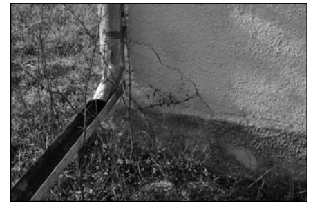
Roskadás miatt megrepedt sarok, utólagosan meghosszabbított csatornakifolyás
