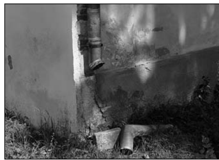
Hiányzó lefolyócsatorna-darab, az áztatott faláról leesett a vakolat
