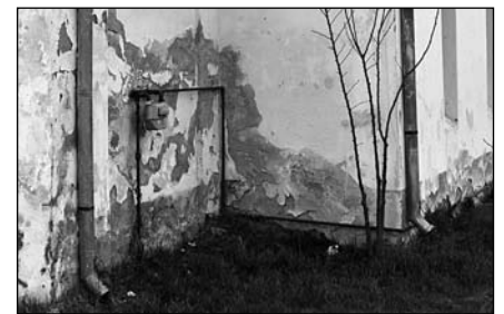
Rövid csatornakifolyások, mögöttük nagy felületen nedves fal, tönkrement vakolat. A szerző felv.
