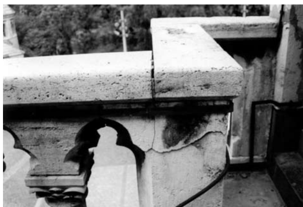
3. ábra. Átrepedt forrásvízi mészkő korlát pántolás rögzítése. Az esőtől védett részekben fekete mállási kéreg van a mészkövön
