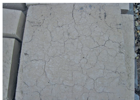
Fig. 7. Map-like cracks 7. ábra Térképszerű felületi repedések
