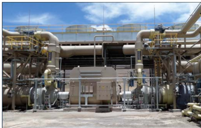
9. Középen a generátor (24MW), két oldalán egy-egy turbina (12MW)
