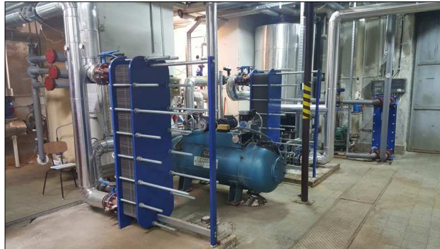
Termál hőcserélők a vasvári Járdányi kazánházban
