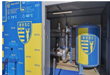
A BVSC geotermikus hőellátója
