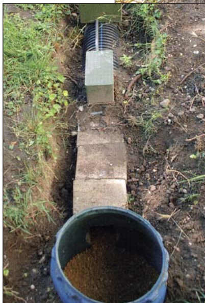
Régi típusú műkotorék-csapda beton és vaselemekből
