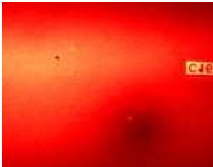
20. ábra. Víz beszivárgás által keltett sötét folt (jobbra) és a horpadás okozta világos terület (balra) a C16-os képmező termográfiai képén
