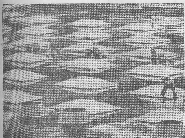
Ludwigshafen egyik új irodaházát víztető-szigeteléssel látták el. A lapos tetőt állandóan 4 cm-es vízréteg borítja. Nyáron a víz párolgási hője hűti az épületet, télen pedig, amikor a vízréteg megfagy, hőszigetelőréteget alkot.
