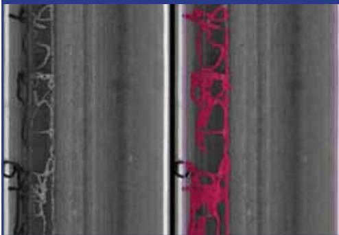
3. ábra: Kiöntött burkolatrepedések LCMS készülékkel való megjelenítése
