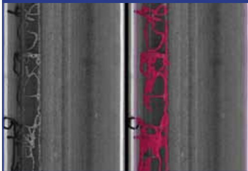
3. ábra: Kiöntött burkolatrepedések LCMS készülékkel való megjelenítése
