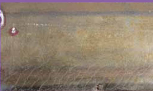
5. ábra: „S” alakú sínfej-hajszálrepedések
