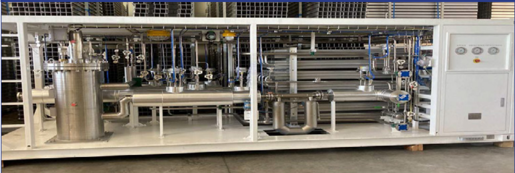
2-3. ábra: LCNG szivattyú skid, és LNG szivattyú skid a hajó lefejtésre, töltésre
