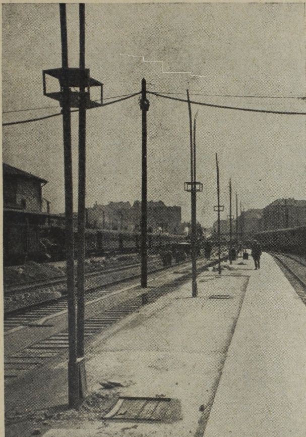
8. ábra. A második közbelső peron betonozása kész, aszfaltozása megkezdve. Az ostor nyeles lámpaoszlopok felállítva (lámpák nélkül). A lámpaoszlopokon látható szekrényekbe a hangtestek nyernei majd elhelyezést (1962. május eleje)
