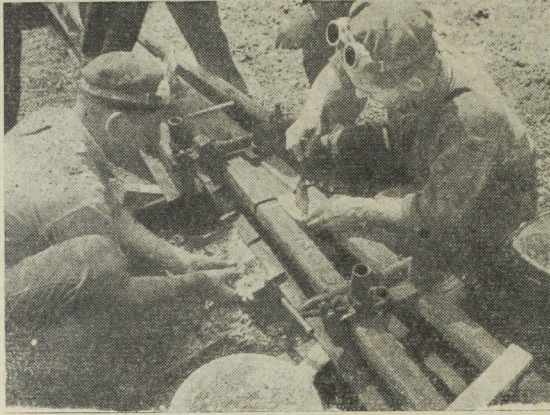
5. ábra. Keresztezési csúcsbetét behégesztése gyorsinhegesztési eljárással: a közbelső formadarabok és a talpvarrat részére készített forma elhelyezése
