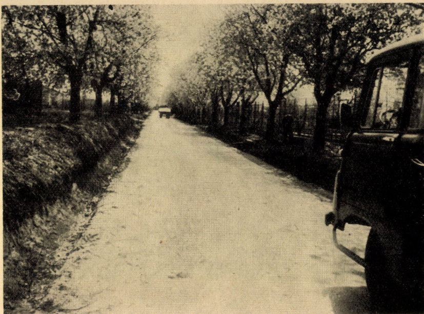
9. ábra. A gárdonyi Meggyfasor meleg bitumenes kavicsburkolatának az alapja cementtel és pernyével stabilizált helyi kötött talaj
