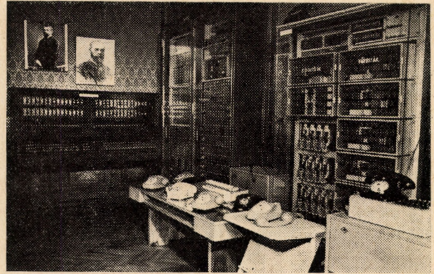
6. ábra. A működő V/25-ös automata alközpont és crossbar-központ, háttérben a (Puskás testvérek fényképe alatt) a Puskás-féle manuális központ
