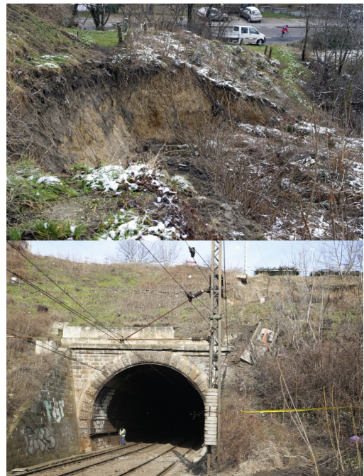
17. ábra: Alagút támfal földcsuszamlása (forrás saját)
