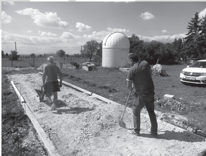
Munkában a munkagép, munkában a fiúk! Mártha Zoltán, Jankovics Zoltán és Máté Attila dolgozik a betonosított észlelőhelyek kialakításán (fotó: Mizser A.)
