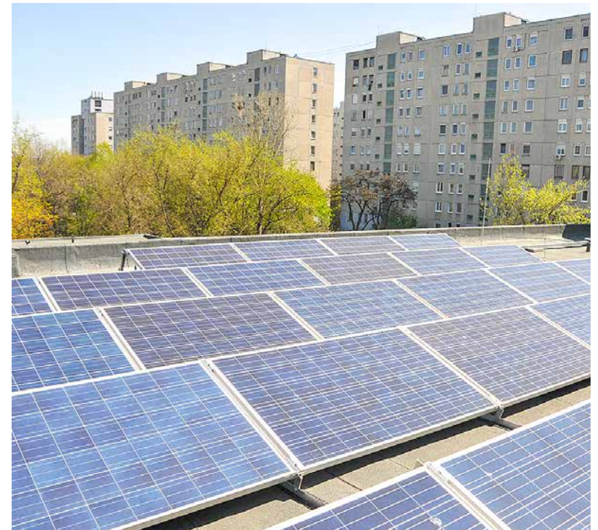
Napelemes rendszert építettek ki a Puskás iskolában
