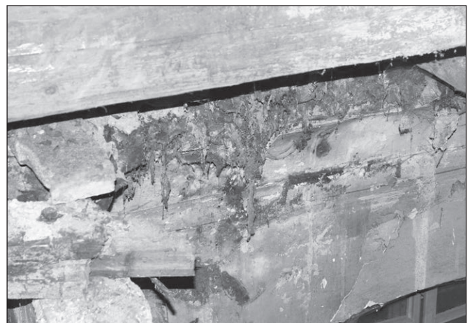
■ Foto 5. Miceliu rămas expus după prăbușirea planșeului © Octavian COROIU ■ Photo 5. Mycelium exposed after the collapse of the slab © Octavian COROIU
