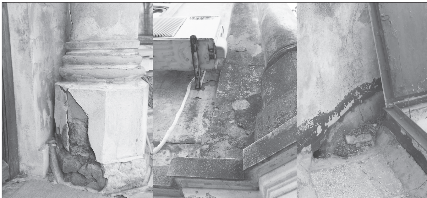
■ Foto 6. Degradări la nivelul fațadelor
