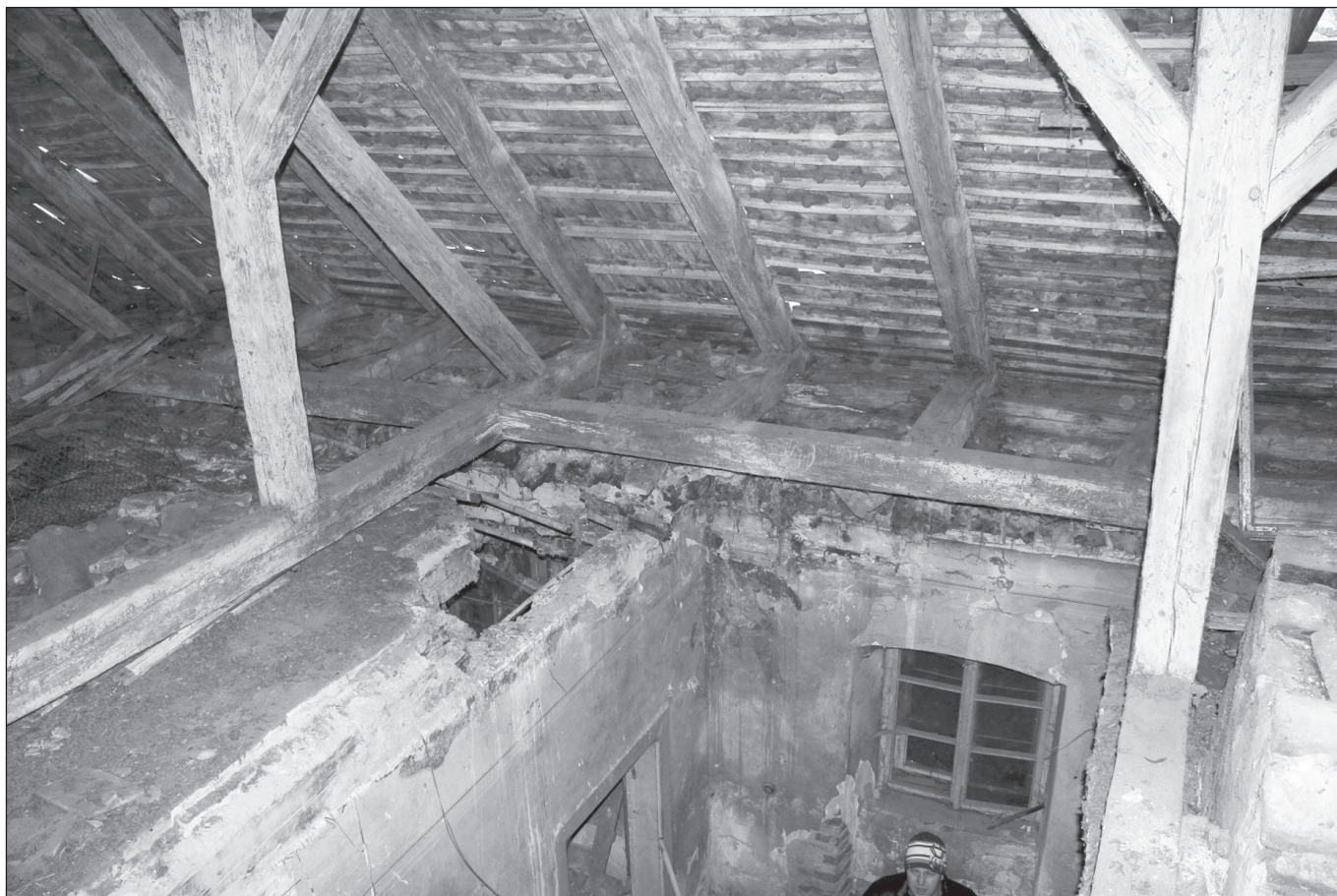
■ Foto 6. Planșeu prăbușit în urma atacului de Serpula lacrymans © Octavian COROIU ■ Photo 6. Ceiling slab collapsed following the Serpula lacrymans attack © Octavian COROIU
