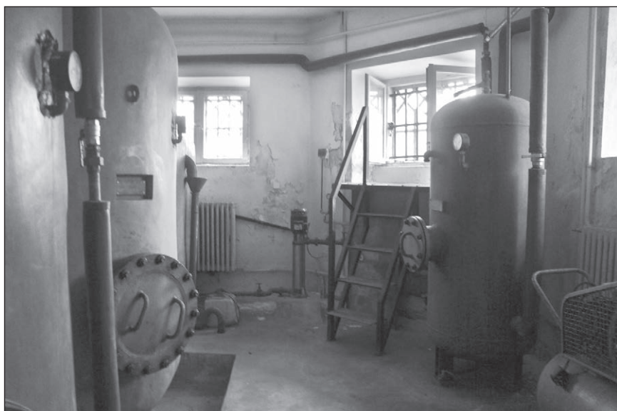
■ Foto 7. Camera tehnică din demisol
