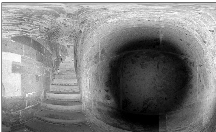
8. ábra. Beégett falszakasz a szűk lépcsősor egyik álláspontjáról készült pontfelhő panorámaképe.
