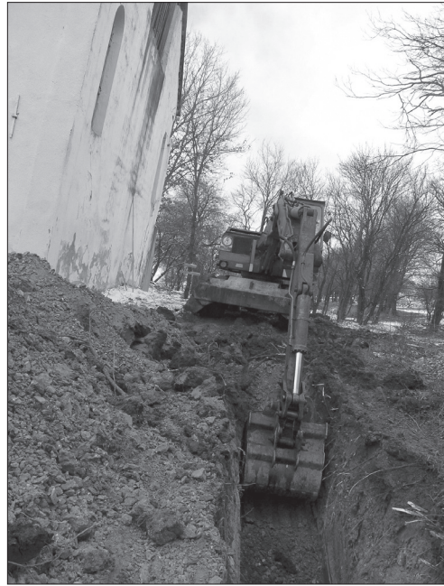
3. ábra 2004-es drénezés a templom északi részénél.
