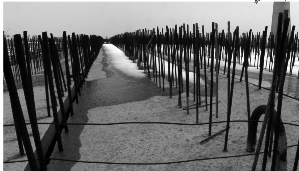
A vasszerkezet jócskán korodálódott a munkálatok szüneteltetése alatt
