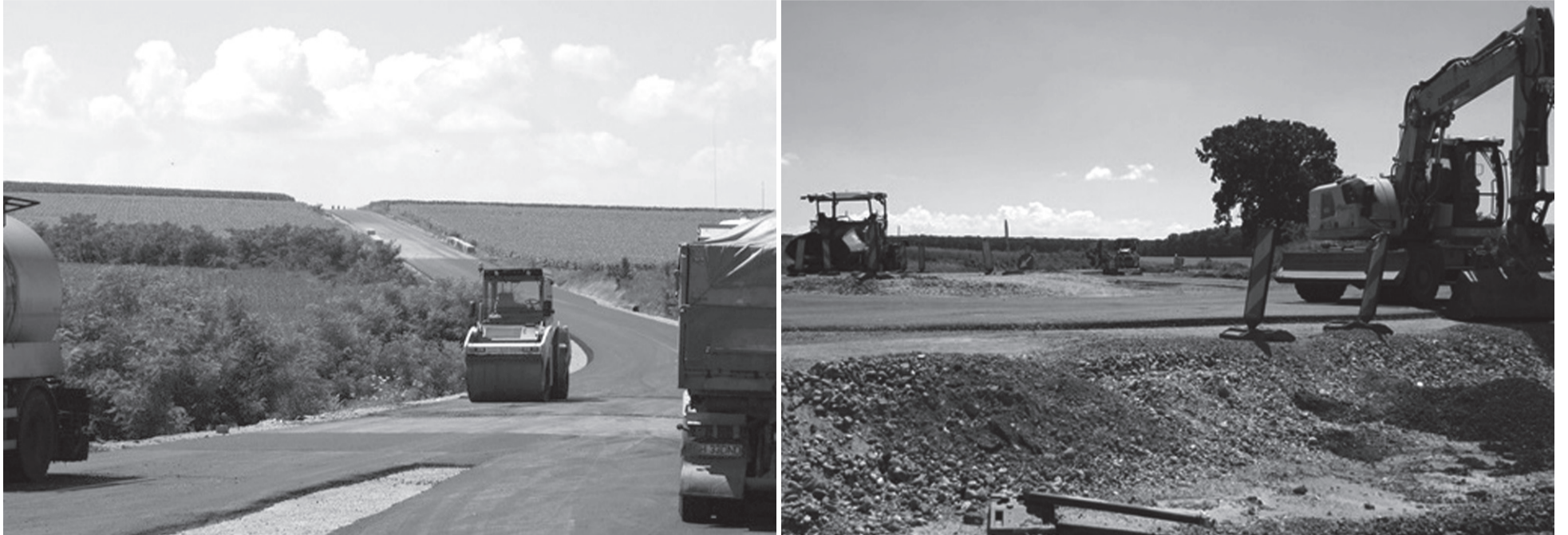
Megfelelő léptékben haladnak a munkálatok az elkerülőúton. A kivitelezők folyamatosan dolgoznak, tartják a megvalósítási ütemtervet
