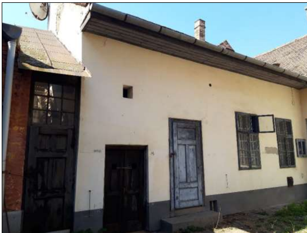
7. kép A beforduló traktus – a megsüllyedt pince felett a szerkezet károsodott 14
