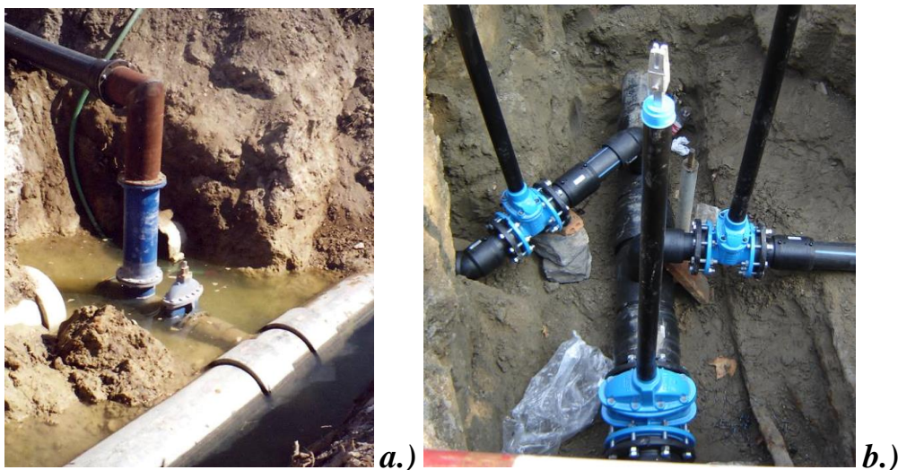
a.) rekonstrukció Keszthelyen DN/ID 500 mm azbesztcement .cső kiváltására DN/OD 630 mm PE csővel, (szerény csomóponti kialakítással), b.) Ivóvíz építése PE csővel Budapesten Rippl Rónai utcában.
