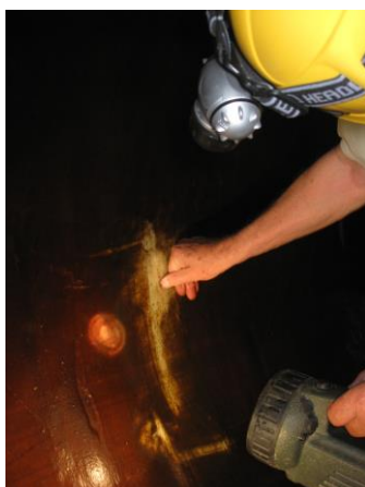
2.2.2.5 ábra: Hidrolízis, vasbeton ivóvízvezeték ÜPE béléscsövén. A bélelés 25 éve készült.
