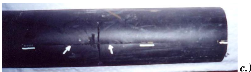
2.2.2.8 ábra: PE csővezeték hibák ivóvíz csöveknél
