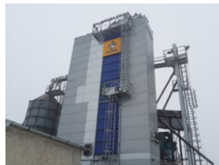
6. ábra. Hővisszaforgatós, energiatakarékos szárítóberendezés (Forrás: saját felvétel)
