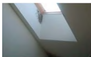
2. ábra. Hibás beépítés következménye
