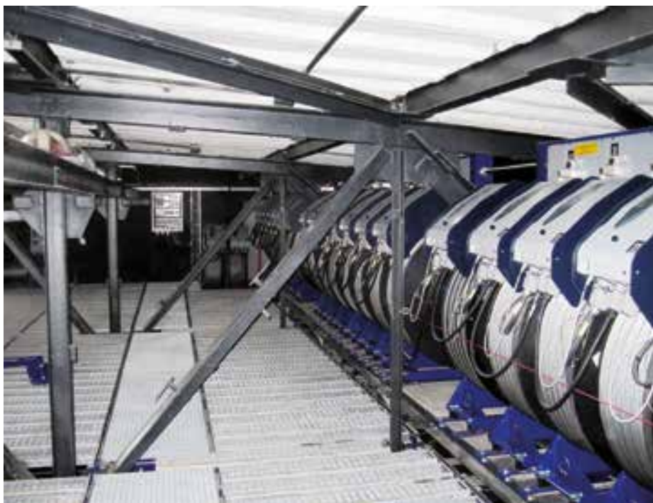
► A gépi díszlethúzó hajtóművei: a megerősített munkakarzatok felett, kétoldalt telepítették a gépeket, a sodronykötelek a taposórács alatt futnak a díszlettartókhoz.
