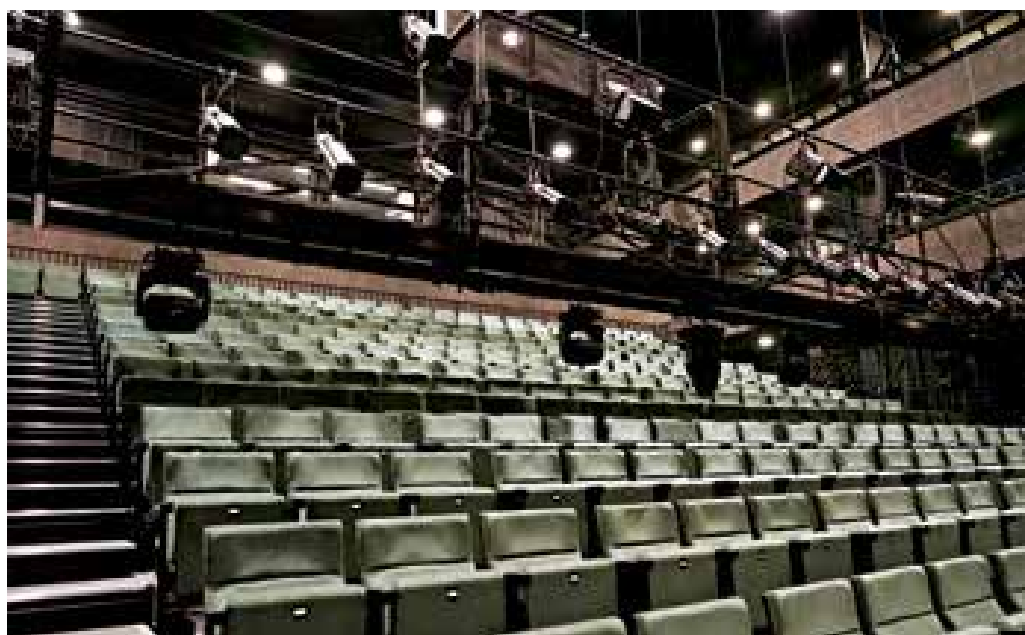
► Nagyterem, nézőtéri világítási híd
