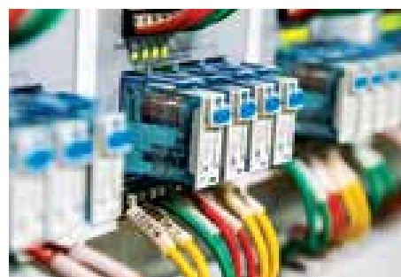
► A négy nagy teljesítményű relé kezelésére képes, KM2614 típusú terepibusz-modul segítségével nagy fogyasztású terhelések közvetlenül a táphálózat-hoz csatlakoztatva vezérelhetők. Minden relé kézi- leg is ki-be kapcsolható
