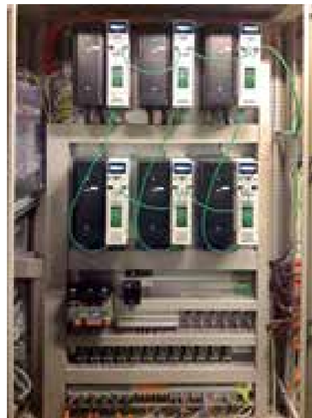
► Fesztivál Színház, főszínpadi süllyedők vezérlése
