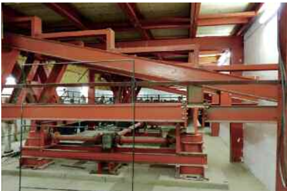
Az üzemképtelen színpadi süllyedő, jól látszik a padlót lépcsősen kiemelő acélszerkezet
