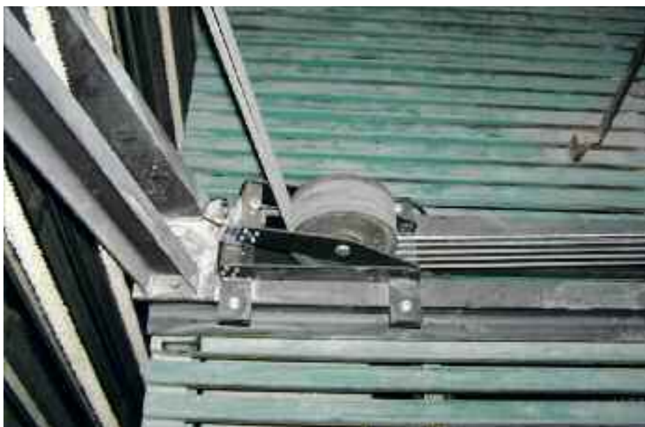
Zsinórpadlás a terhelésmérő kötélteléréssel
