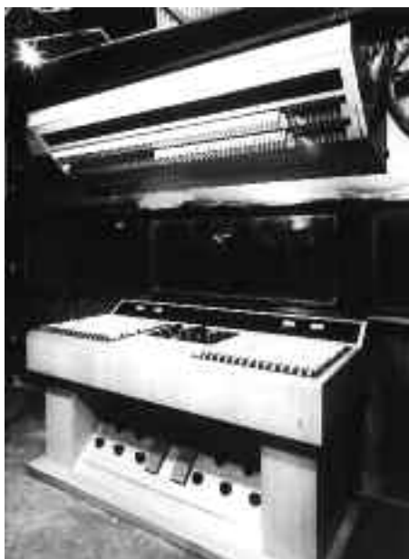
8a ábra. 120 áramkörös, két előbeállító vezérlőasztal (Nemzeti Színház – Hevesi Sándor tér)
