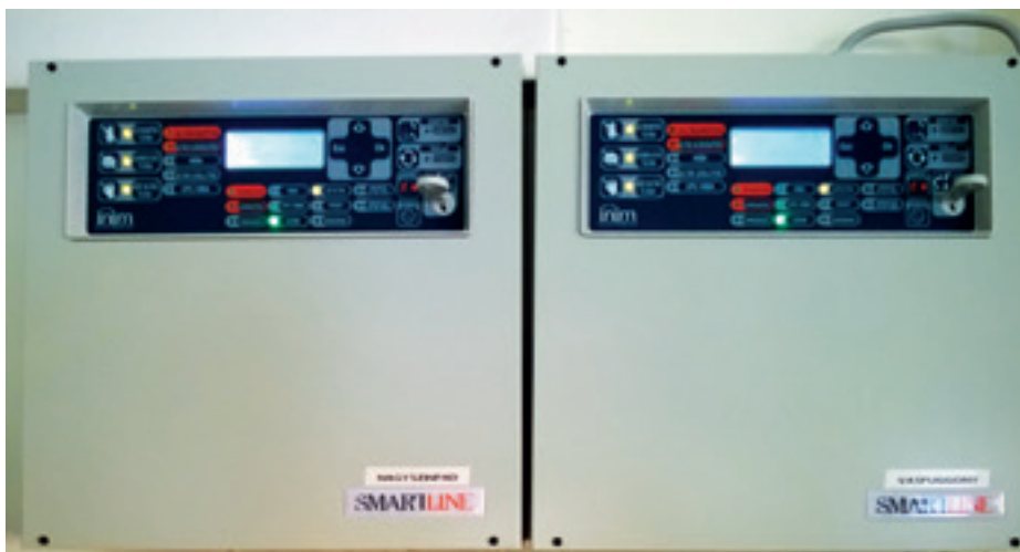
► 8. Központi tűzjelző, ellenőrző rendszer a portán (vasfüggöny, főszínpad)
