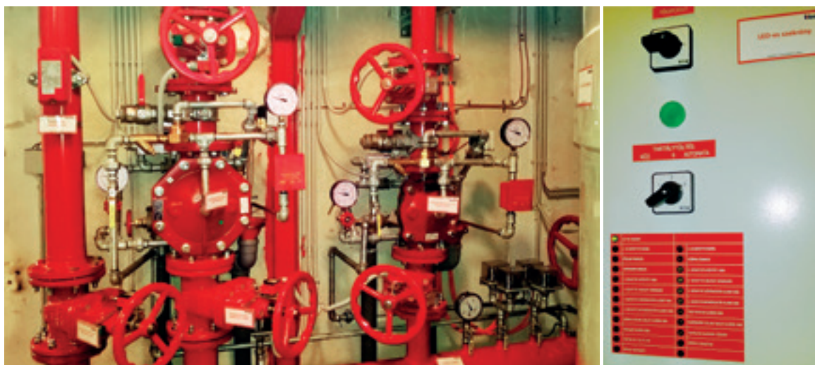
► 5. A tűzoltóközpont csővezetékei és a szelepek, valamint a vezérlőszekrények
