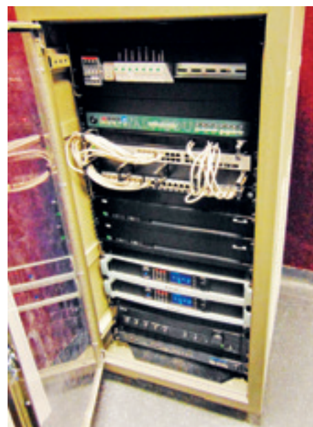
► Erősítőrack a vezérlőben
