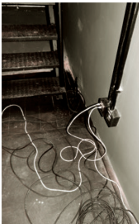
► Csatlakozók rossz helyen
