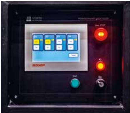
A CP6600 típusú beépíthető panel PC-vel megvalósult díszlethúzó kezelőpultja a hátsószínpadon
