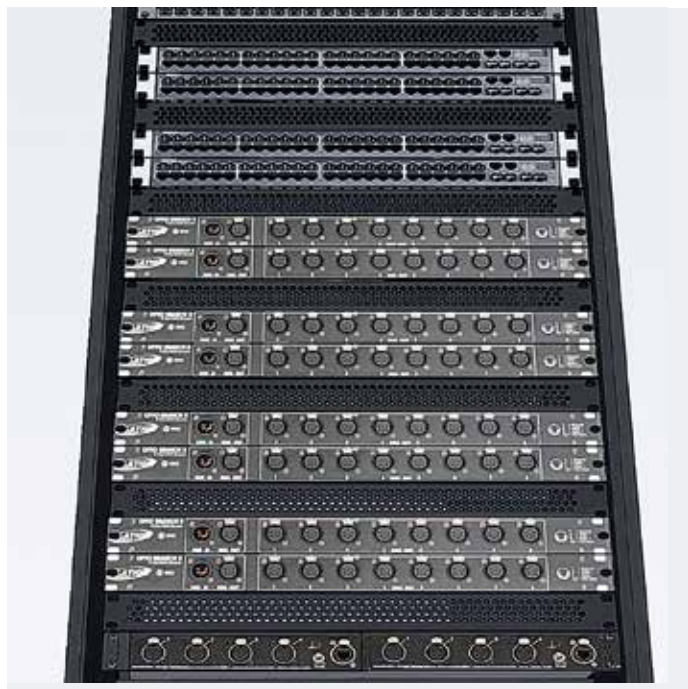
Vezérléselosztószekekény front oldali nézete
