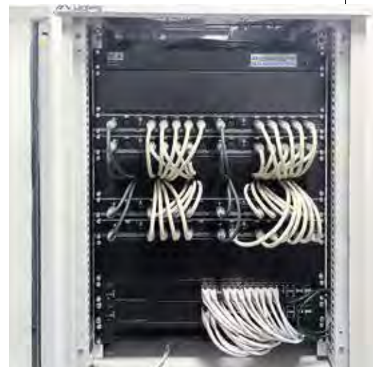
Gyengeáramú vezérlő rack – Stúdió
