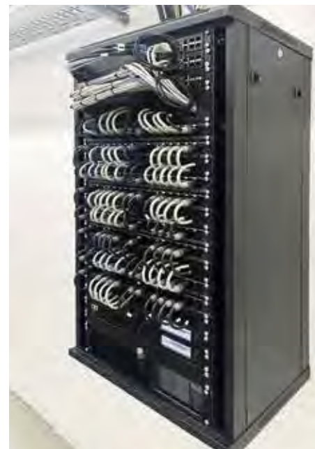
Gyengeáramú vezérlő rack – Nagyszínpad
