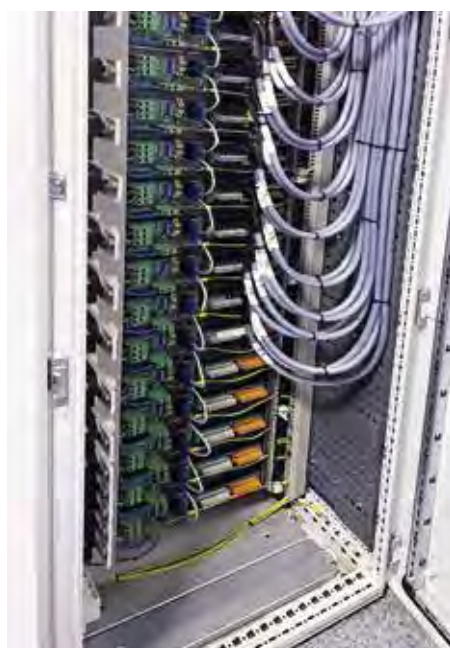
Dimmer szekrény bekötése
