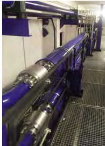
Telepített akkumulátorok a -11 m szinten
