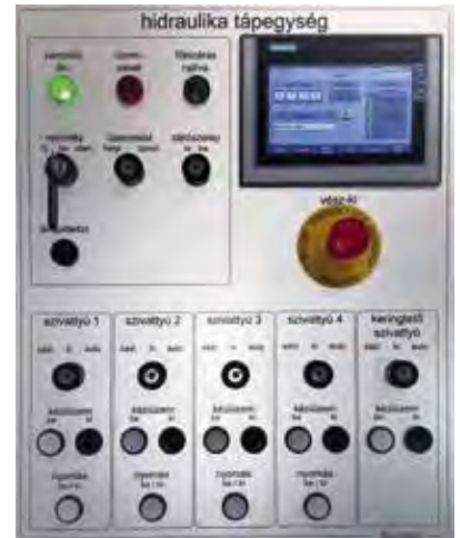
Kezelő és kijelző elemek a kezelőpanelen
